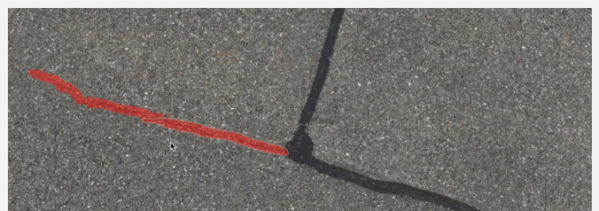
Abbildung 5: Die automatisch detektierten Risse werden rot eingefärbt und mit Informationen zur Länge und Konfidenz des Defekts ergänzt.
